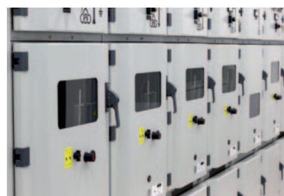
Prévention des risques de court-circuit et d'échauffement
